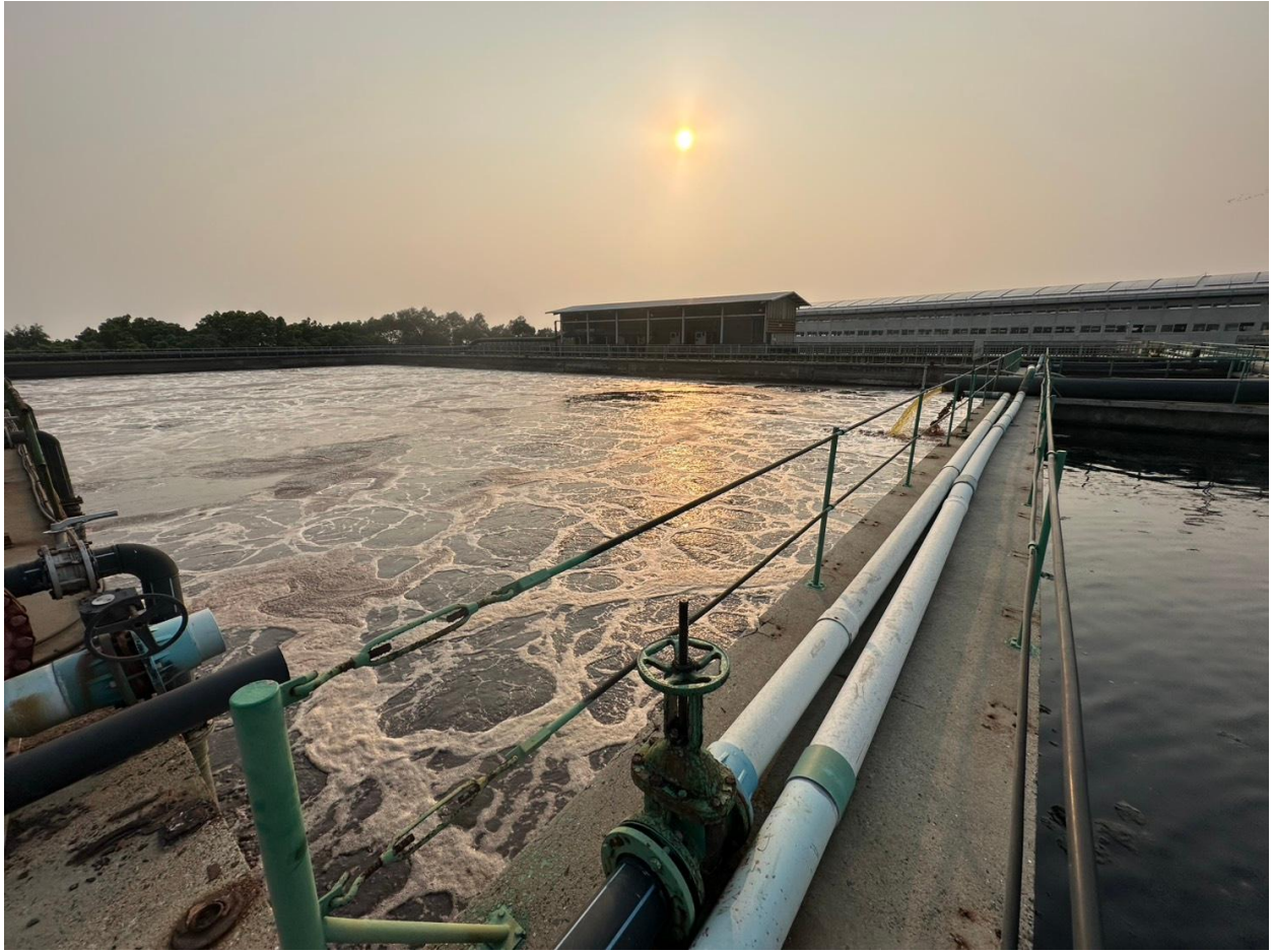
บ่อบำบัดน้ำเสีย เขตประกอบการอุตสาหกรรมฟอทหนัง กม. 34
