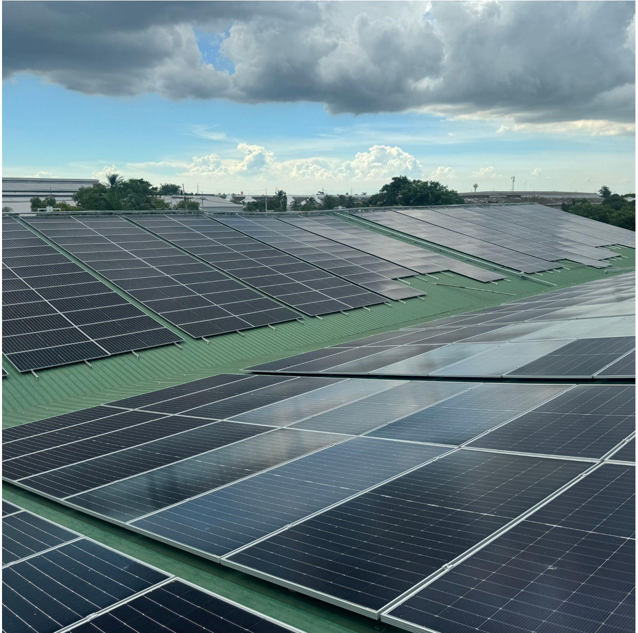
พลังงานแสงอาทิตย์ (Solar Rooftop)
